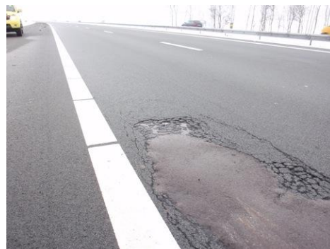
Afbeelding 2. Schadebeelden Nobelpave, veroorzaakt door vorstschades en lokale problemen in kleeflaag (2010)
