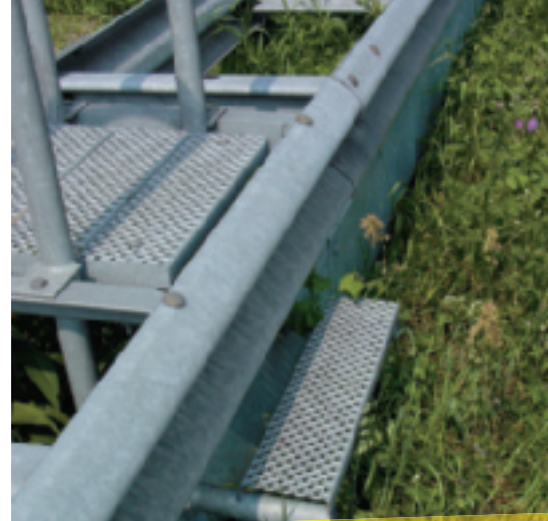
Gevaarlijke overstapconstructie voor motorrijders
