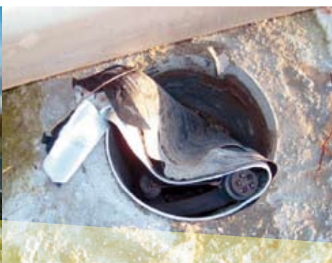
Detail van de plofstekker in de aangerezen lichtmast
