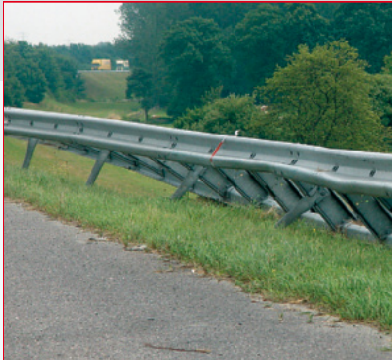
uitbuiging met onvoldoende steun van de berm
