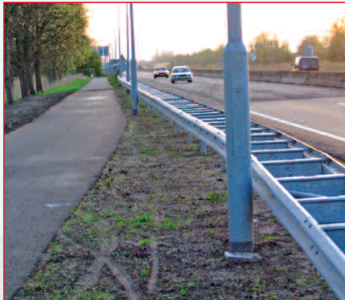
Voorbeeld van een lichtmast die te dicht achter de geleiderailconstructie is geplaatst
