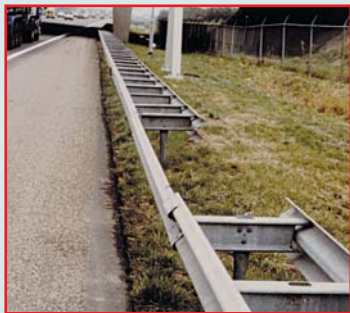
Een onveilige onderbreking van de geleiderail voor onderhoud
