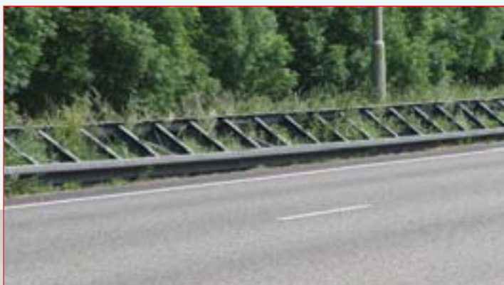
Geleiderail langs de A12 omgevallen door warmte-uitzetting
