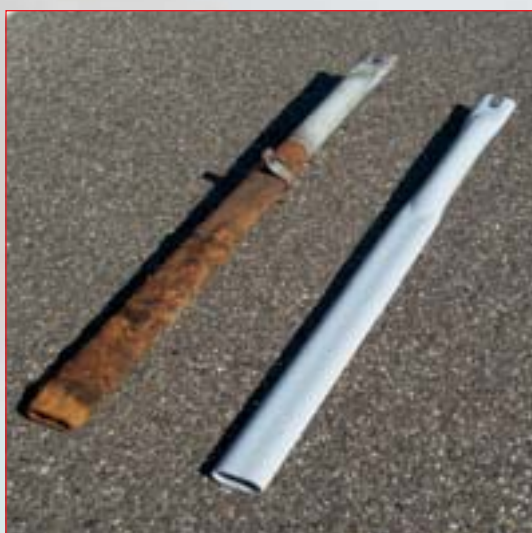
Verscheidene geleiderailstijlen langs de A50 zijn zwaar aangetast door corrosie.
