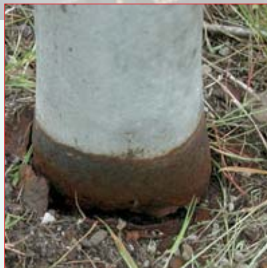
De roestlaag begint direct op maaiveldhoogte.
