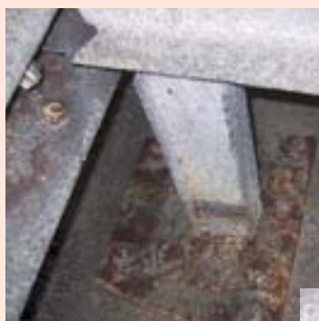
Corrosie van de geleiderail onder het viaduct Woeste Hoeve
