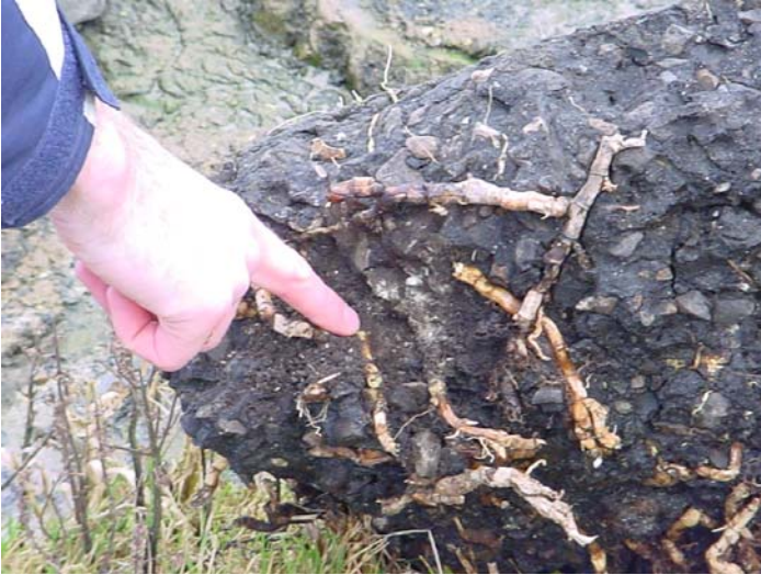
Foto 2. Mogelijke doorgroei van waarschijnlijk riet wortels in asfalt van onderuit.
