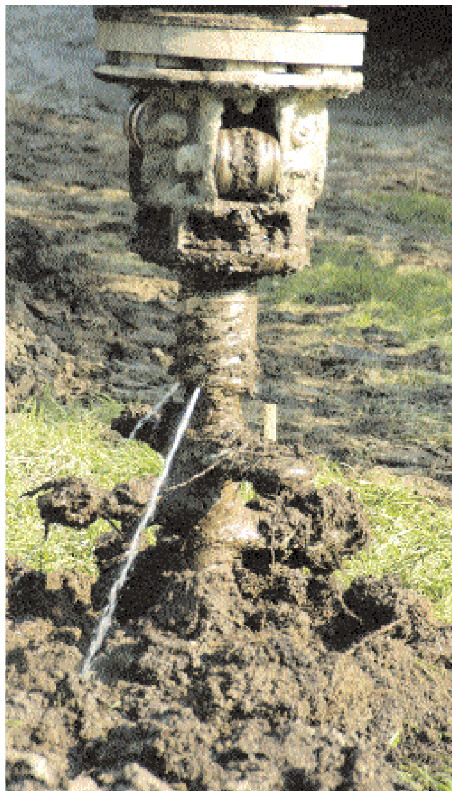
Mixed in place in de praktijk: een kraan vermengt droog bindmiddel met vochtige ondergrond. Na verharding ontstaat een gestabiliseerde grondkolom.
