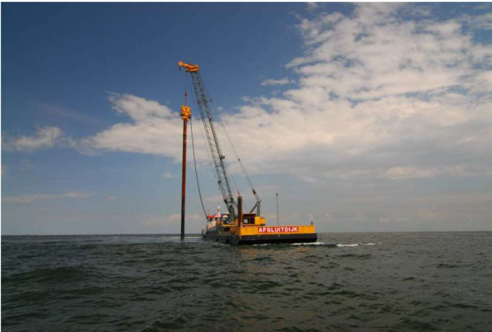
Figuur 3. Werkschip "Afsluitdijk" fa. Klein Wieringen tijdens het positioneren van het 20 m-paalanker (uit de Haan & Burggraaf 2012).
